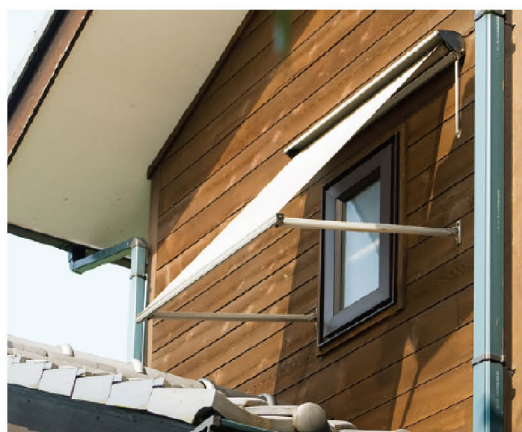
外部のオーニング。直射日光を遮りながら、室内に外気を取り入れることができる
